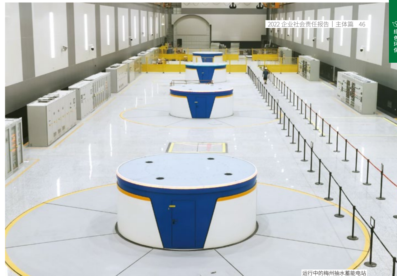
运行中的梅州抽水蓄能电站
